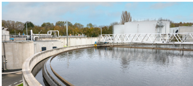
Station d'épuration de Bourge Plus (18)
