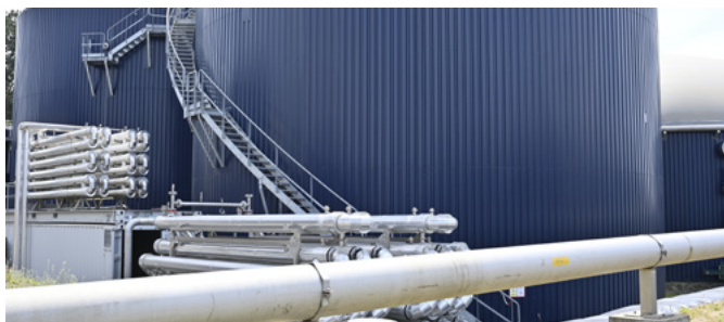
Site de méthanisation à Château-Gontier (53)
